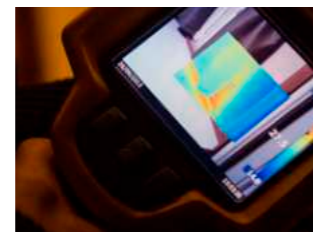
Mit Hilfe von Wärmebildkameras stellen wir sicher, dass unsere Konstruktion genau der Qualität entspricht, die wir anstreben.
