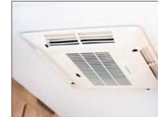
Klimaanlage im Wohnbereich Fresh Jet FJ2200
